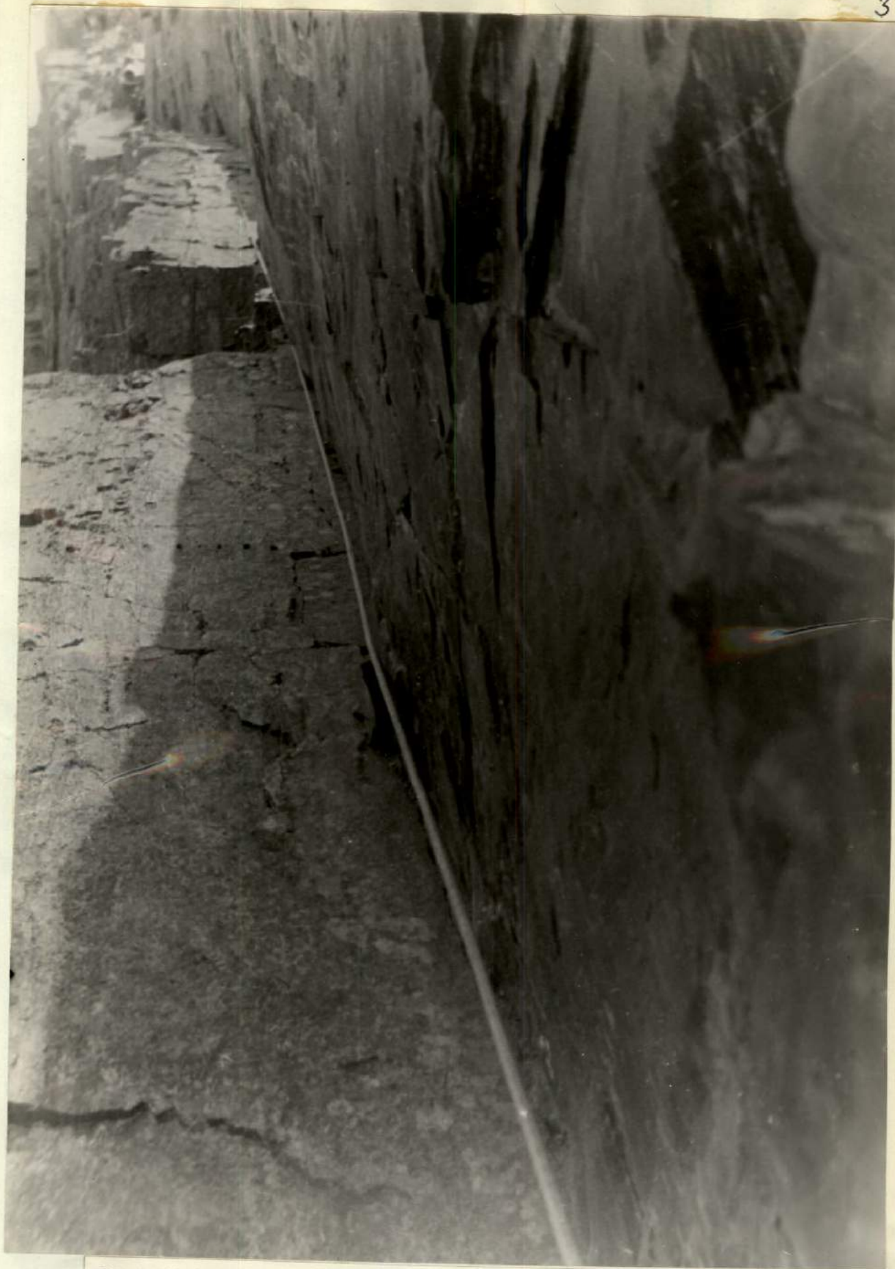
Фото 13 Внутренний угол. Отвесные заглаженные скалы, отслаивающиеся плиты /участок IO-II/.
